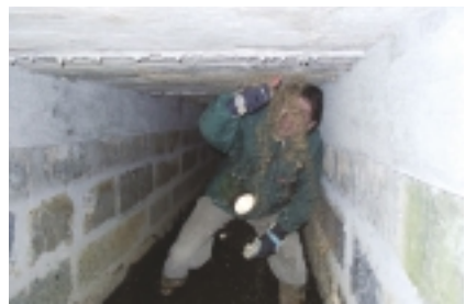
Contrôle d'un ouvrage d'art en Côte-d'Or avant travaux. Travaux sur le pont de Barnay (Saône-et-Loire).
